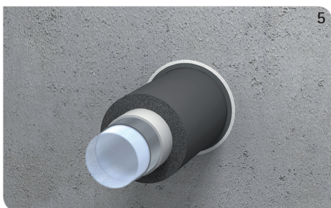
Ggf. Kontrolle der Abschottung.
